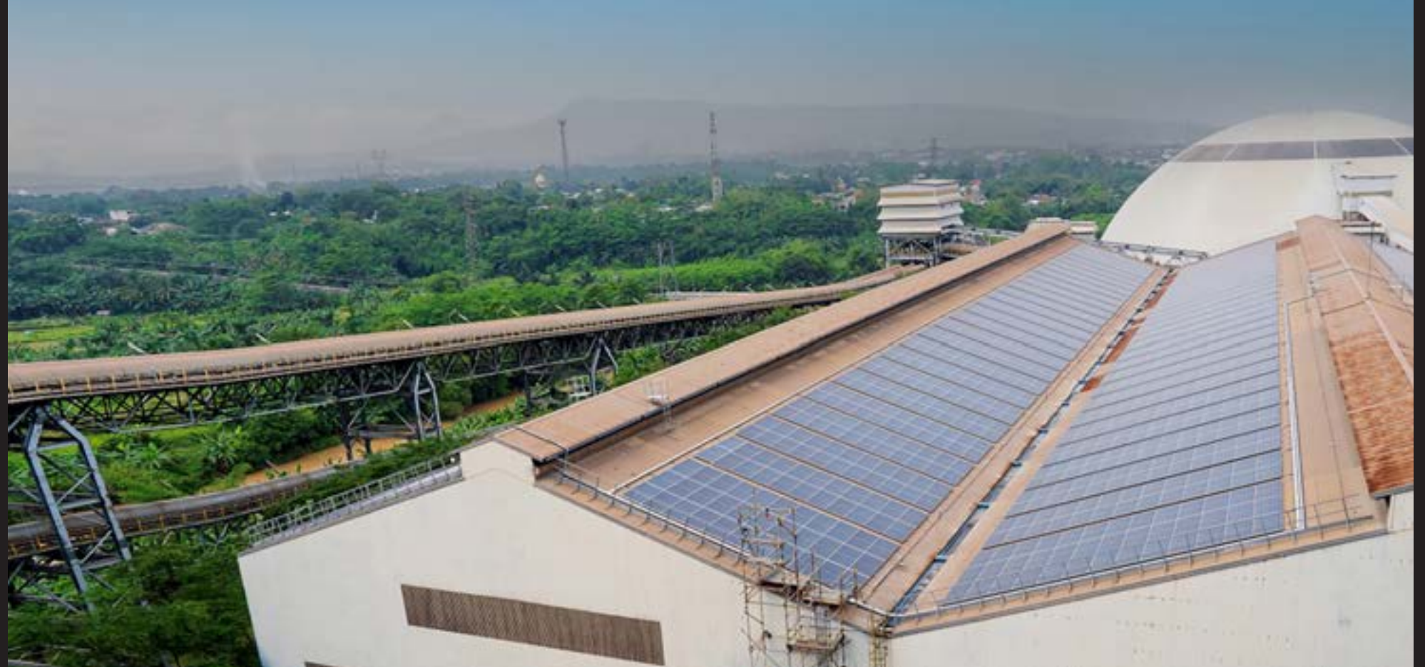
Rooftop solar panel di Indocement Kompleks Pabrik Citeureup pada tahun 2024.
